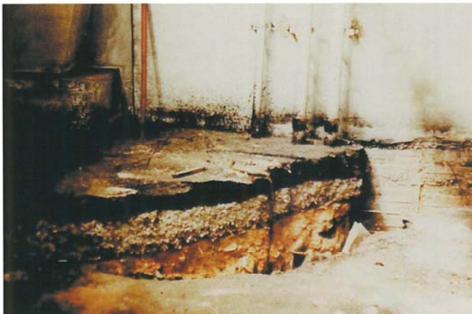
土間コンクリート床の破損
