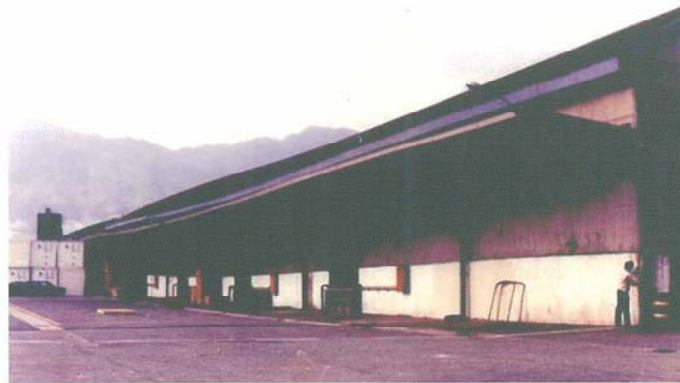
不同沈下建物例
